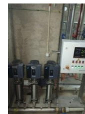
насосная станция ХВС
