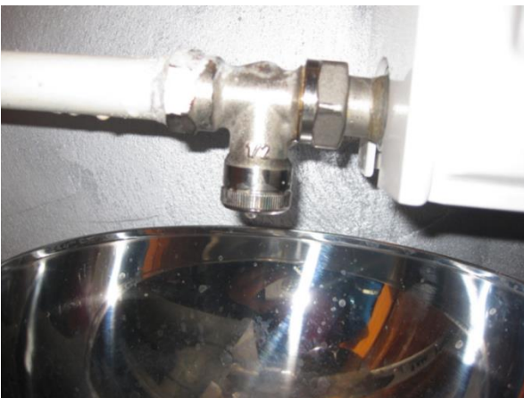
Собственник самостоятельно снял радиатор при окрашивании стен, это привело к протечке
