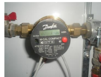
узел учета тепловой энергии в квартире
