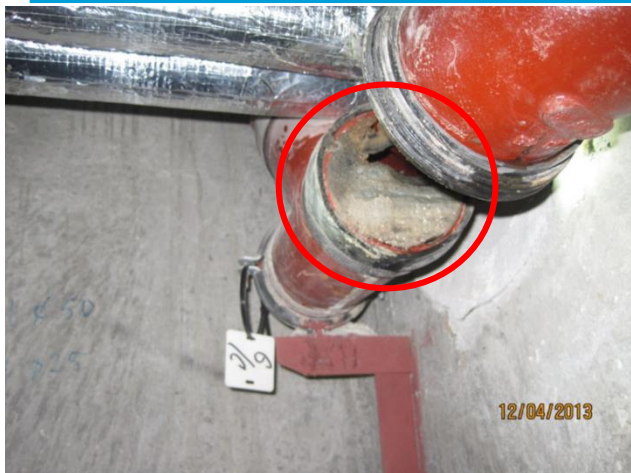
Фановая труба забита строительным раствором
