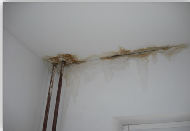
Отверстие от кондиционера не заштукатурено, возникла протечка у соседей
