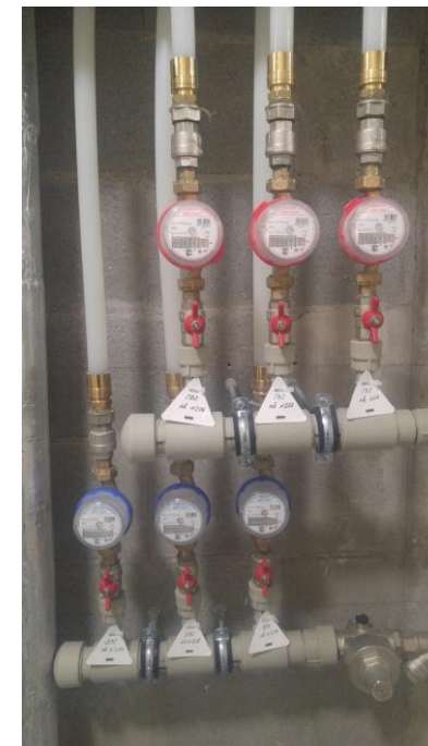
Этажный коллектор водоснабжения с индивидуальными счетчиками воды
