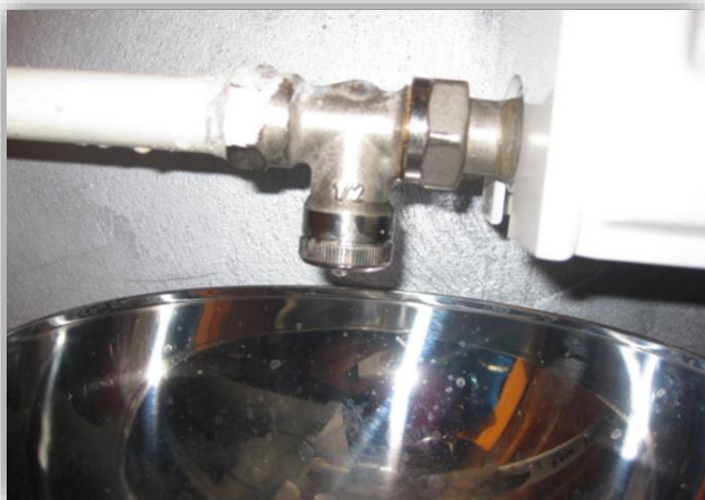
Собственник самостоятельно снял радиатор при окрашивании стен, это привело к протечке
