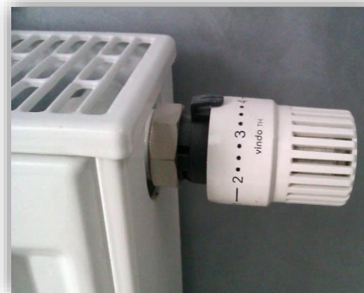
Термостатическая головка на радиаторе отопления
