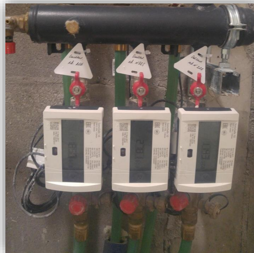
Узел учета тепловой энергии
