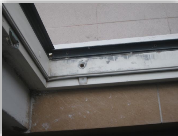
Износ уплотнительных резинок из-за отсутствия должного ухода
