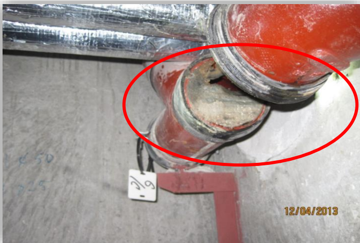
Фановая труба забита строительным раствором
