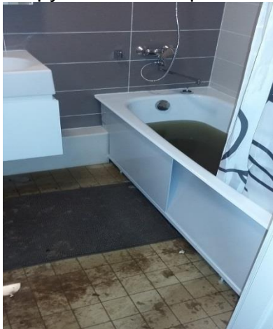
Затопление квартиры фекальными массами после слива в унитаз строительных смесей
