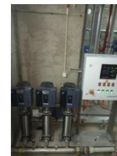
насосная станция ХВС
