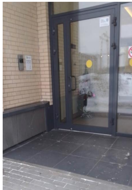
Плитка, подлежащая замене
