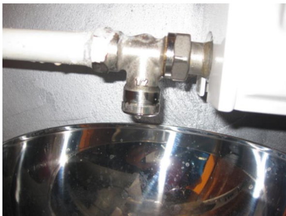
Собственник самостоятельно снял радиатор при окрашивании стен, это привело к протечке
