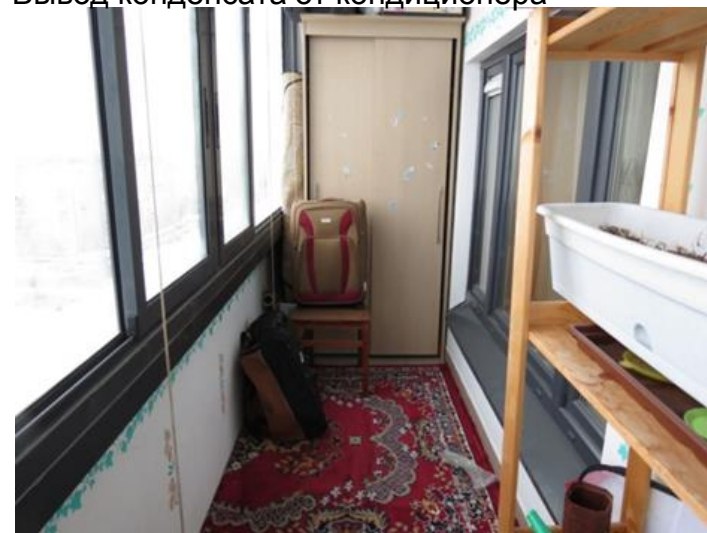
Нарушение правил эксплуатации лоджии: ковер на полу способствует появлению плесени
