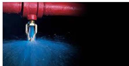
Спринклерная установка пожаротушения в паркинге
