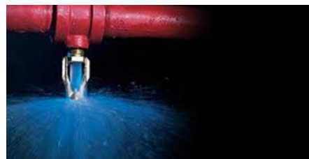
Спринклерная установка пожаротушения в паркинге
