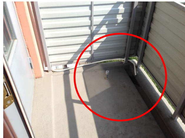
Вывод конденсата на переходной балкон
