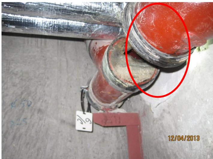
Фановая труба забита строительным раствором
