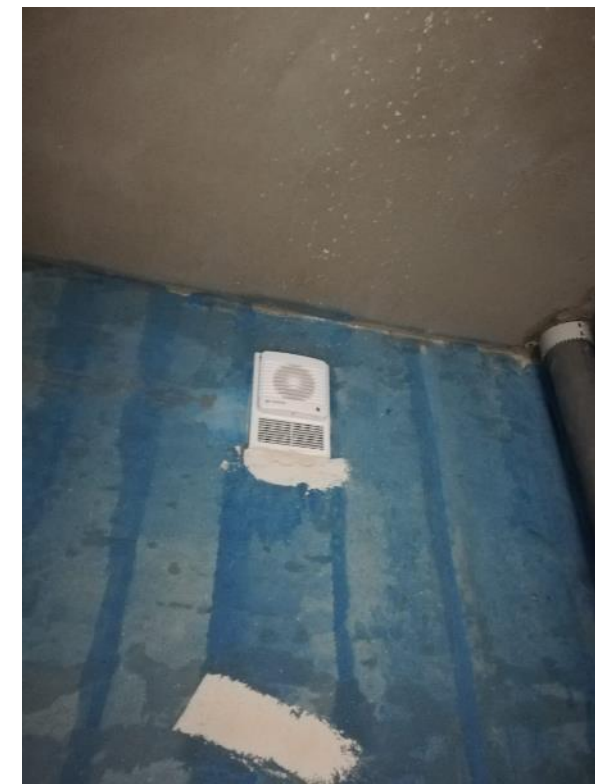
Вытяжной вентилятор Квартир-студий
